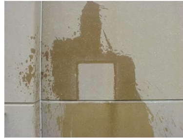
Fig 2. El agua rociada en la pared muestra que el área de 2'X2' no absorbe agua
